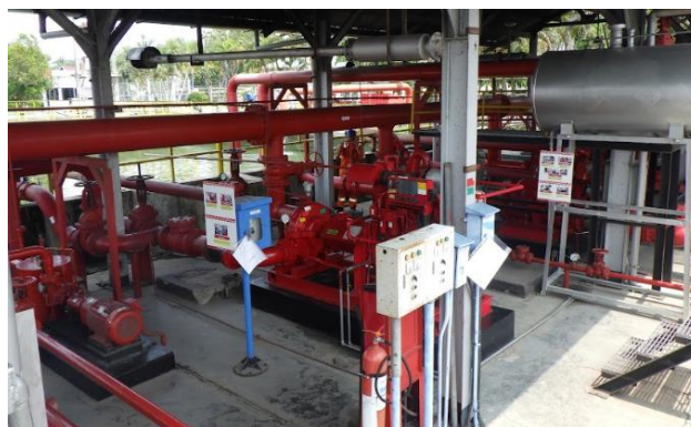
Fig. 2. Pompa Pemadam Kebakaran Fuel Terminal Rewulu
