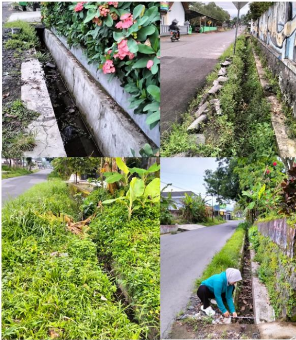
Gambar 6. Kondisi Eksisting Saluran Drainase
