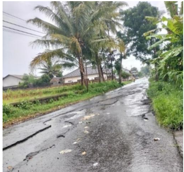
Gambar 2. Kondisi Jalan yang Rusak
