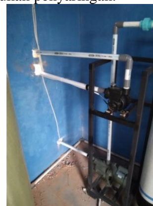
Gambar 4. Instalasi Pompa Filtrasi dan Aerasi
