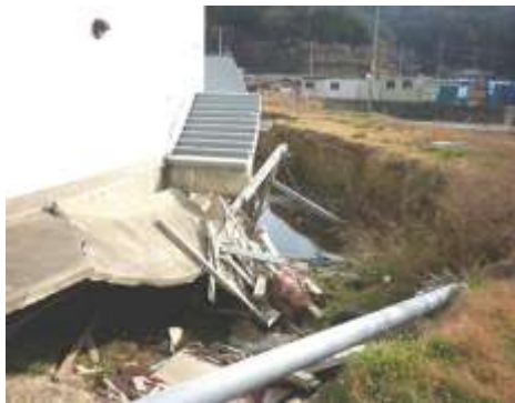
Gambar 3. Kerusakan fondasi akibat scouring (Satyarno, 2018)
