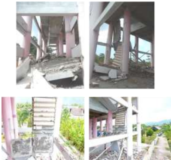
Gambar 1. Kerusakan TES Lombok Utara (Satyarno dkk., 2018)
