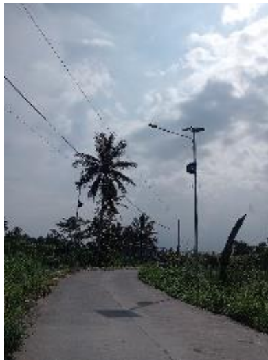
Gambar 4. Jalur evakuasi yang sudah terdapat lampu penerangan jalan bertenaga surya (Sumber: Survei 2024)
