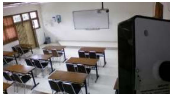
Gambar 3. CCTV pada salah satu ruangan kelas JPTEI
